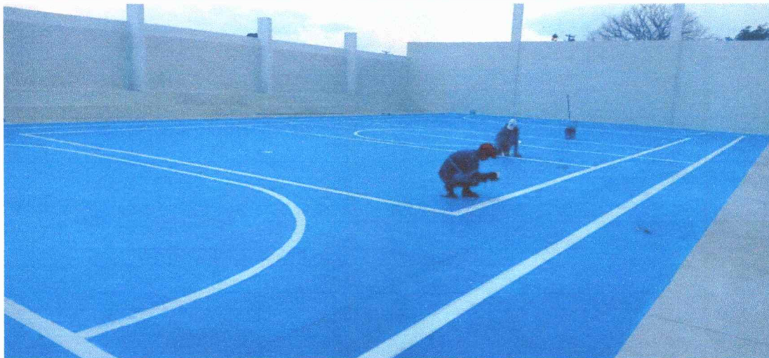
Anexo 02: Quadra poliesportiva do sitio Lagoa de São João em construção. Data: 05/04/2024
